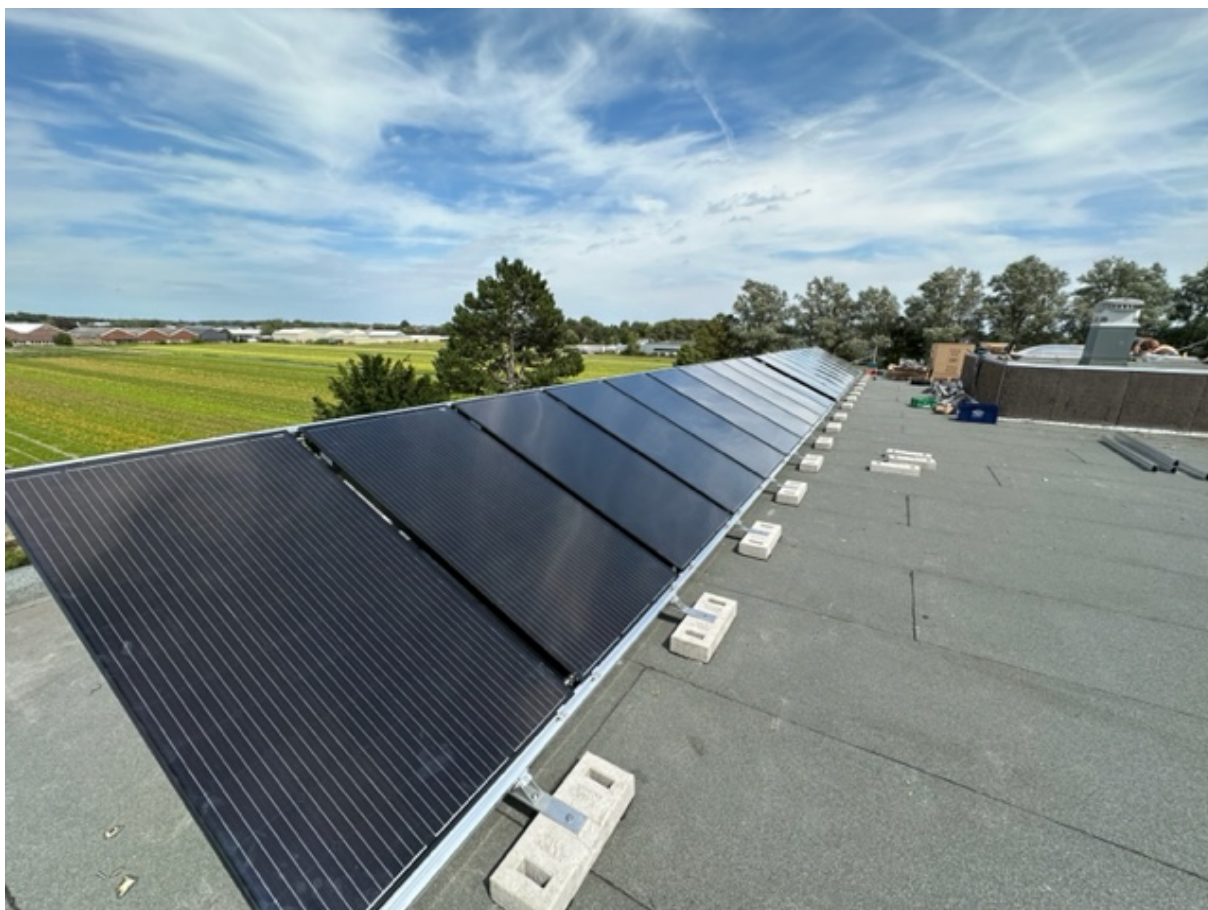
Bild från en av 2023 års många installationer
